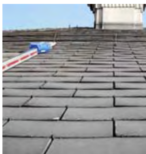
2 Tetto con lastre in fibrocemento contenenti amianto
