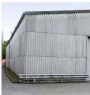
1 Facciata rivestita di lastre contenenti amianto
